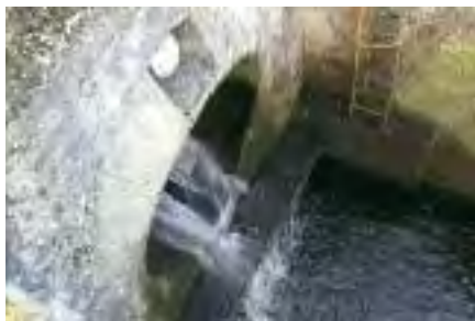
L'entrée de la conduite forcée conduisant à l'usine
